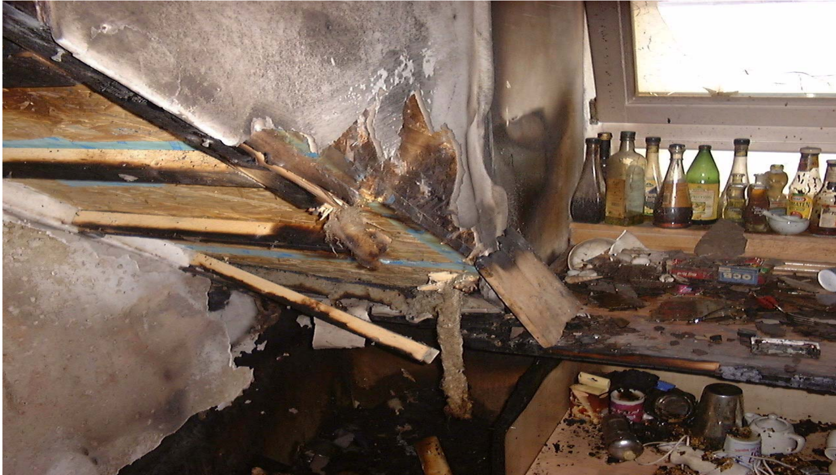
Brand in einem Dachgeschoss
