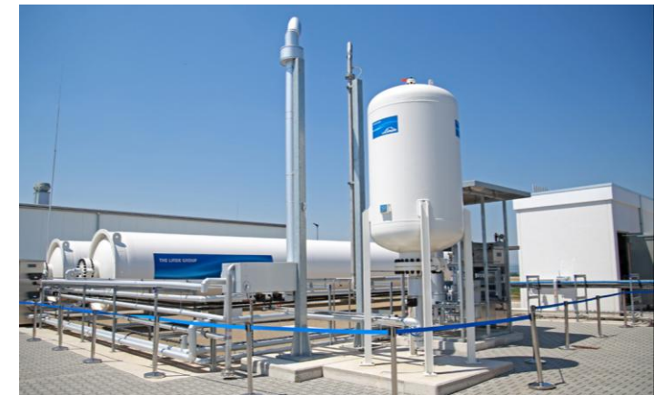
Bild: Energiepark Mainz
